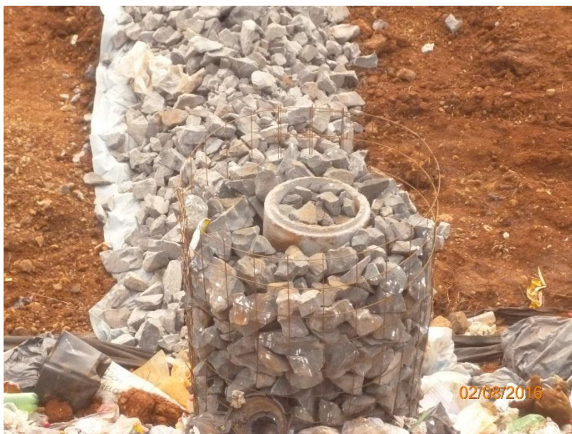
Figura 9 - Dreno de gases
