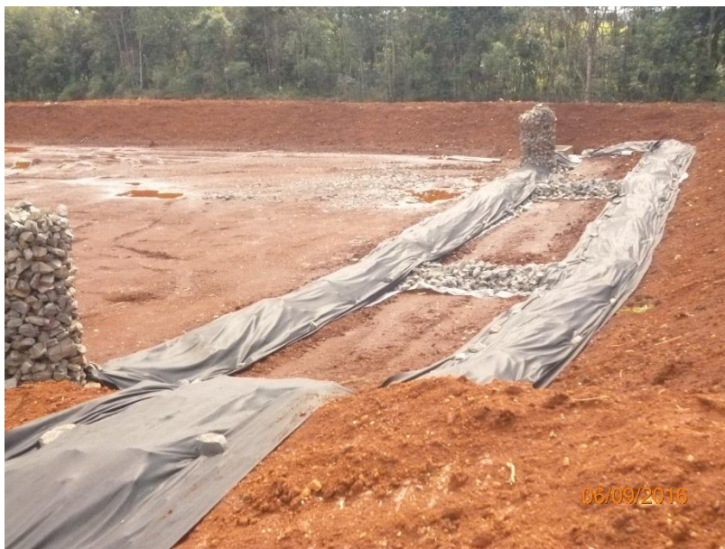
Figura 10 - Drenos de lixiviados
